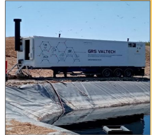
Unité d'osmose inverse mobile
